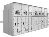
Aparamenta revestida de metal
