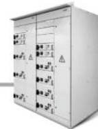
Aparamenta de baja tensión y Centro de Control de motores
